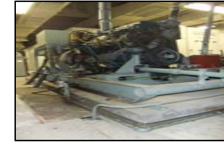
耐用年数を経過した防災設備の例
