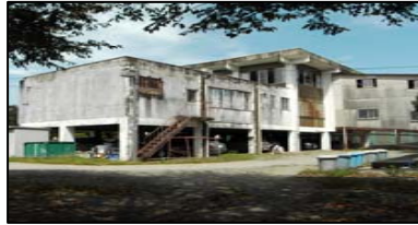
老朽化した庁舎の例
