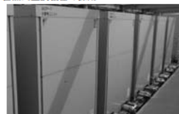
氷蓄熱式空調機器の採用
