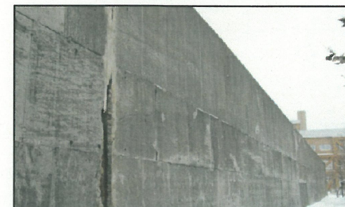
老朽化した外塀の例
