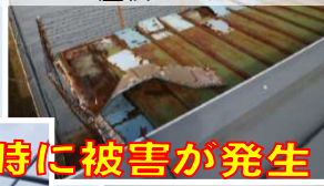
屋根のめくれ
