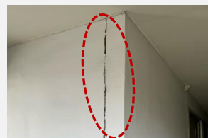
老朽化により壁に大規模な亀裂
