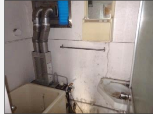
浴室・トイレが老朽化している。
