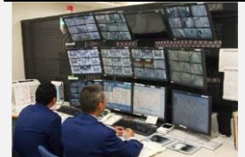
矯正施設の保安警備力を支える基幹システム
