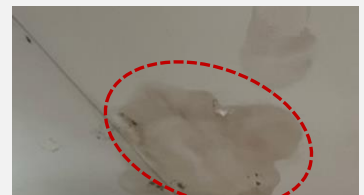
老朽化に伴う漏水による腐食
