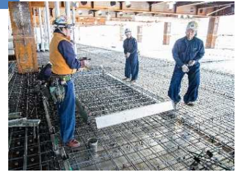
[မျက်နှာပြင်ပေါ်တွင် သံမဏိ rebar formwork လုပ်ခြင်း (အယ်ဘက်တွင် နိုင်ငံခြားသားအလုပ်သမား)]
