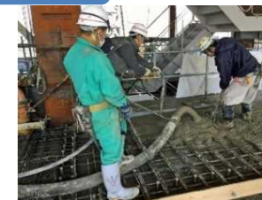
[Hình ảnh đang sử dụng bơm áp lực để đưa bê tông vào cốt pha panen]
