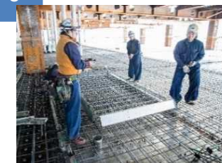
[Phong cảnh công việc lắp ráp cốp pha panen thép trên cốt thép (bên trái là nhân lực nước ngoài)]
